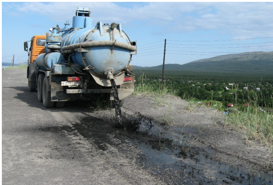
Рис. 7. Закрепление дорожного полотна на хвостохранилище АНОФ-2 с помощью анионной битумной эмульсии. Фото Л. А. Ивановой
